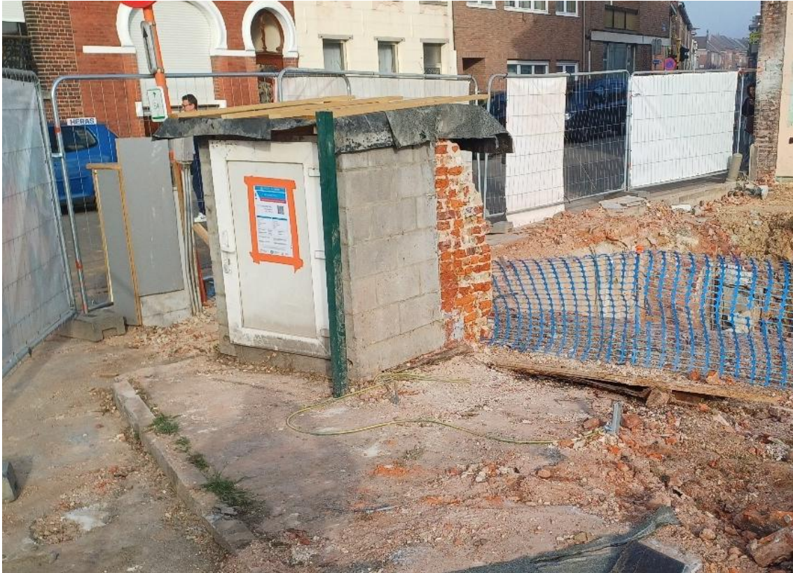
Figuur 8: Elektriciteitskast met aardingspinnen aan de Stationsstraat
