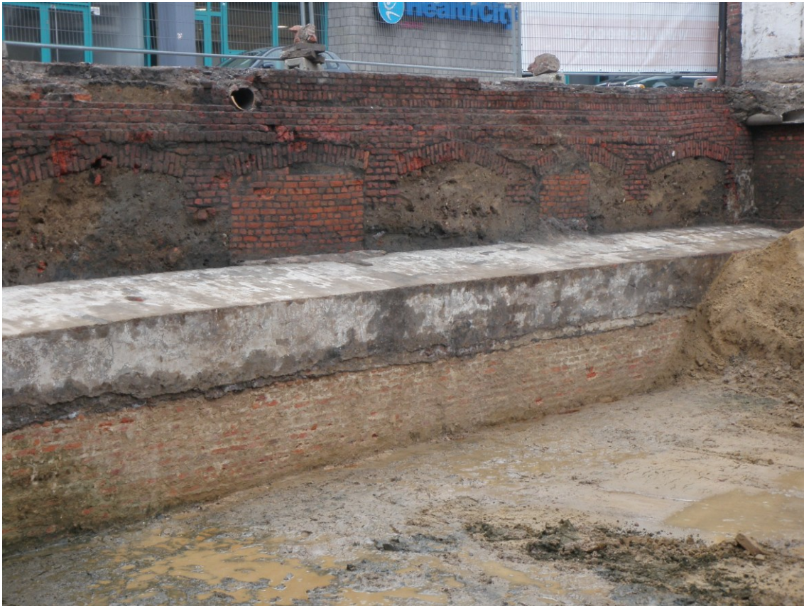
Figuur 40: Bovenste deel van de contrescarp (binnenzijde), vastgesteld bij het onderzoek ten zuidwesten van het onderzoeksgebied, met bovenaan (bovenste 50 à 60 cm) een cementbekleding (Deville et al. 2014, 37, fig. 25).
