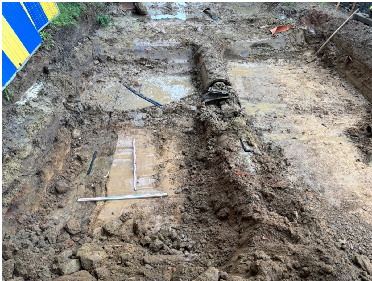
Fig. 1.12: Zuidelijke deel na raken van de waterleiding.
