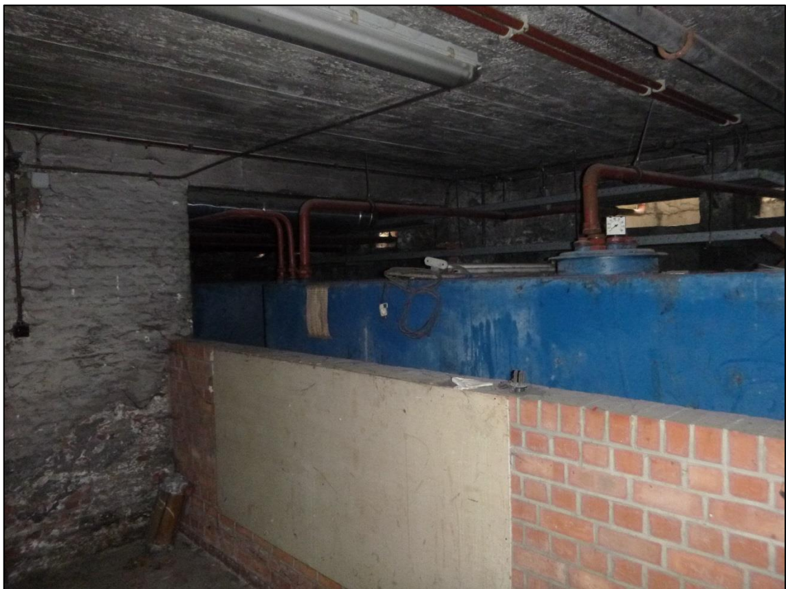
Figuur 6: Kelders blok T en W: technische ruimtes (foto's genomen op 15/09/2016 door Pedro Pype)
