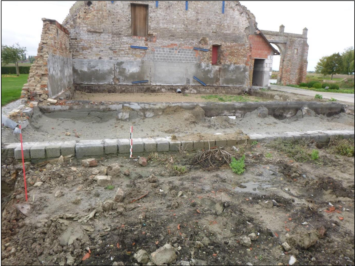
Figuur 7: Bestaande toestand bij aanvatting van het archeologisch onderzoek. De zuidelijke gevel staat nog recht. De meeste muren van het zuidwestelijke deel zijn al afgebroken tot op de bovenzijde van het vloerniveau. Er is zichtbaar dat het maaiveld ter hoogte van het noordelijke deel van de schuur ongeveer 20cm lager lag dan de bovenzijde van de muren.
