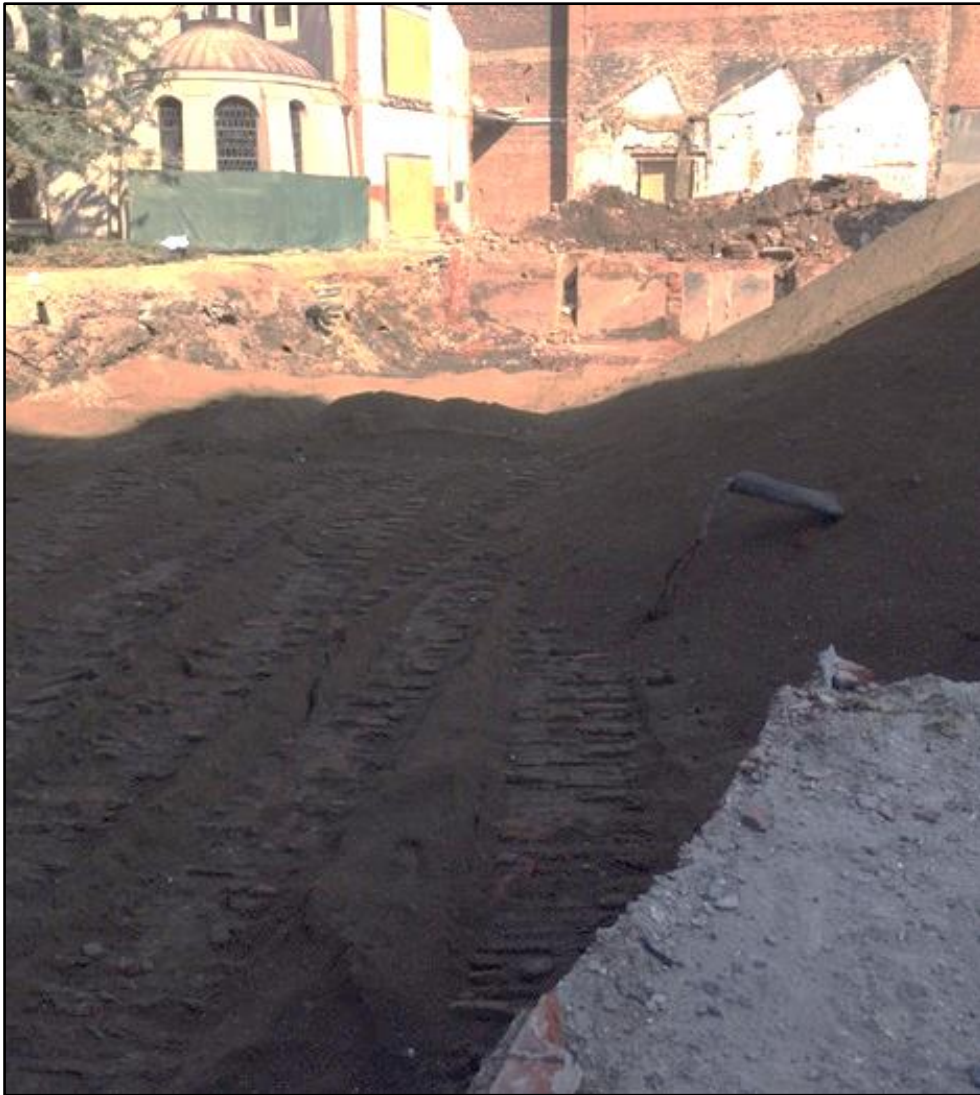
Figuur 24: Opgepulde kelders (Bron: initiatiefnemer 2018)
