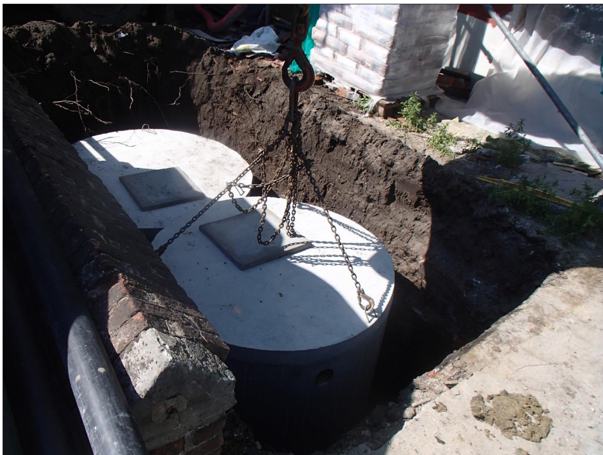
Figuur 1: Foto van het plaatsen van de nutspullen ter hoogte van werkput 4, na afronding van en aansluitend aan het archeologische veldwerk. Zoals zichtbaar is op de foto werd de grootte van de archeologische werkputten aangepast of gelijkgesteld aan de maximale bodemingreep.
